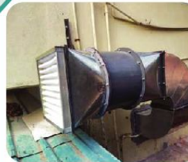
Fresh Air Blower Axial Flow Fan
